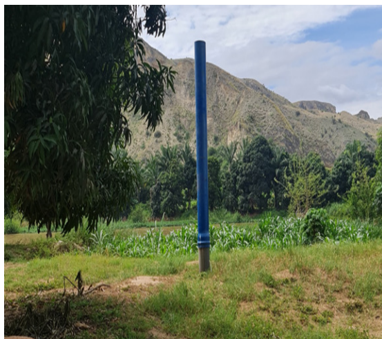
FIGURA 9: CAPTAÇÃO DE ÁGUA SUBTERRÂNEA
